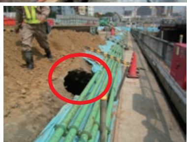
土砂流出による地盤陥没の例
