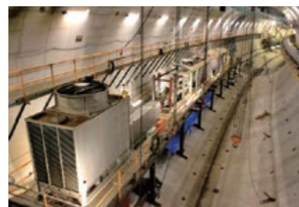
トンネル坑内 冷凍機ユニット
