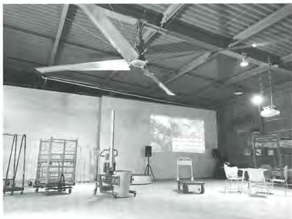
写真5 ジャロックテクニカルトレーニングセンター (Jarock Technical Training Center/通称: JTTC) 内観とリボリューション (HVLS) ファン
